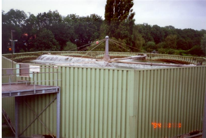
Tropfkörper der Betriebskläranlage
